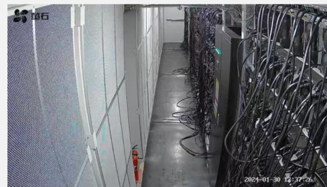
矿箱内部实时监控
